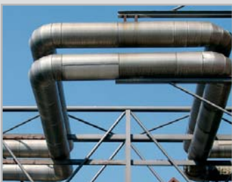
工程管路配件
